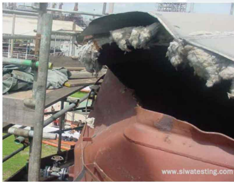
รูปที่ 11 การเสียหายของหลังคาถังจากความดันเกิน
